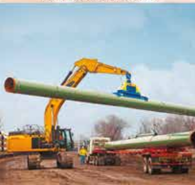
Sistema de elevação a vácuo
