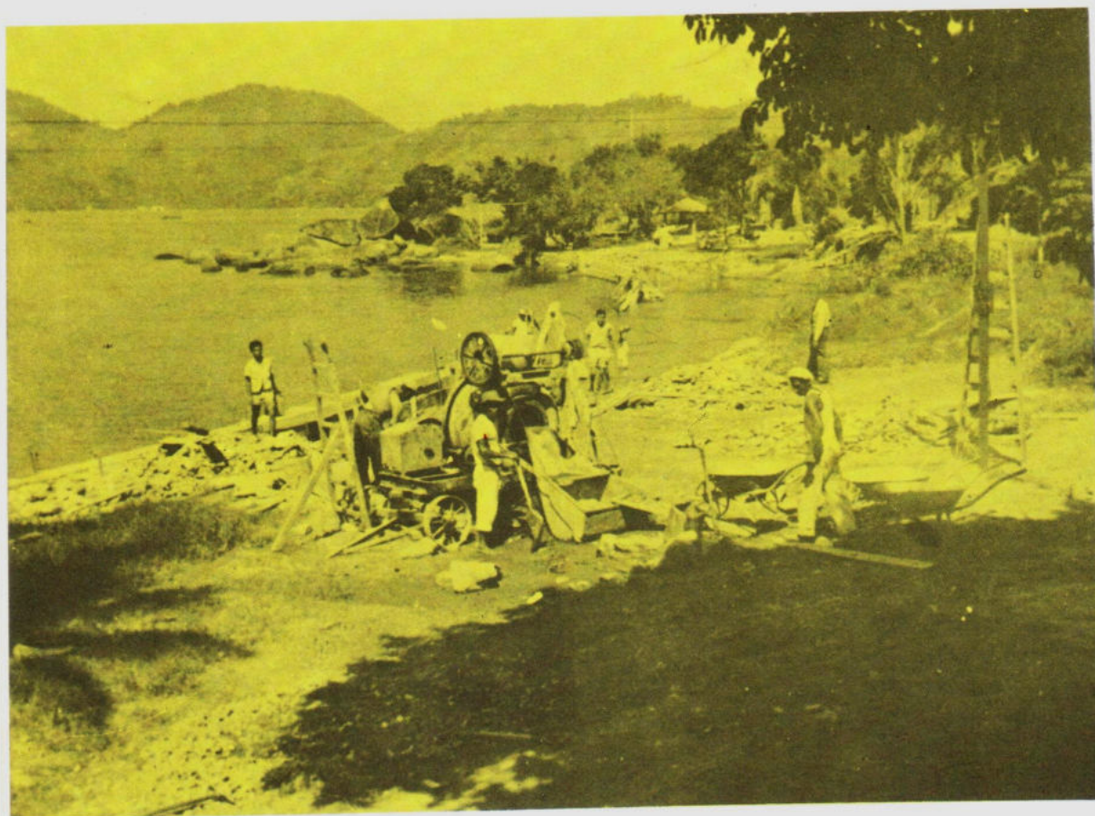
Foto de 1951 quando se começaram as obras de construção dos cais da Taperinha — no fundo será colocado o clube Coqueiro.
