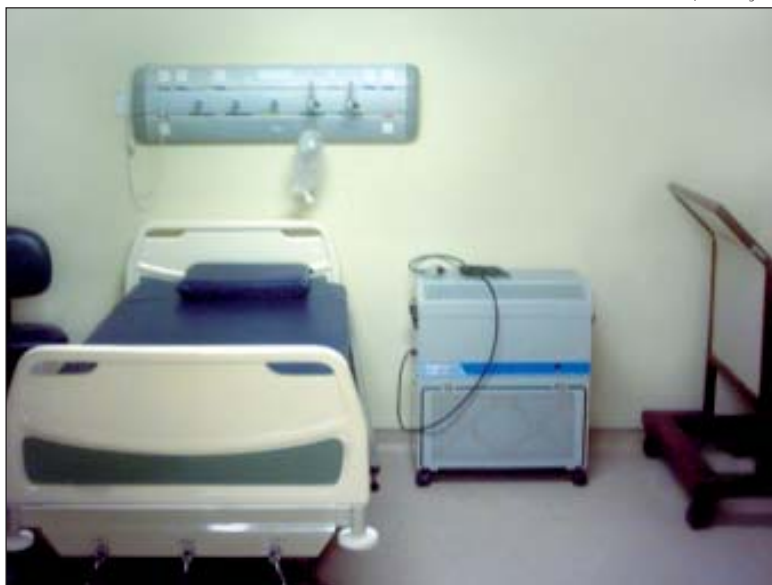
Interior de quarto na Enfermaria dos Pacientes Irrradiados do HNMD. Observa-se o laminado de chumbo para a proteção da equipe
