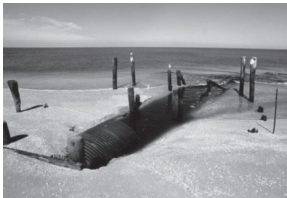
Figura 11 – Esgoto sendo lançado ao mar Foto: Michael Goodman
