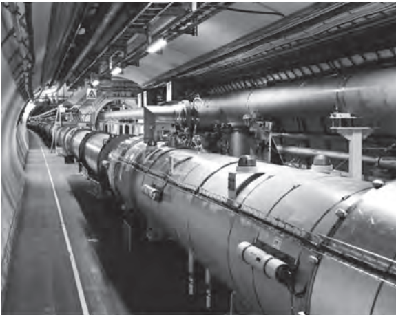
Figura 4. Túnel do acelerador LHC
