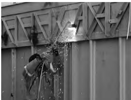
Militar da Marinha trabalhando na construção dos módulos emergenciais na Antártica (Foto: Eduardo Carvalho/G1)
